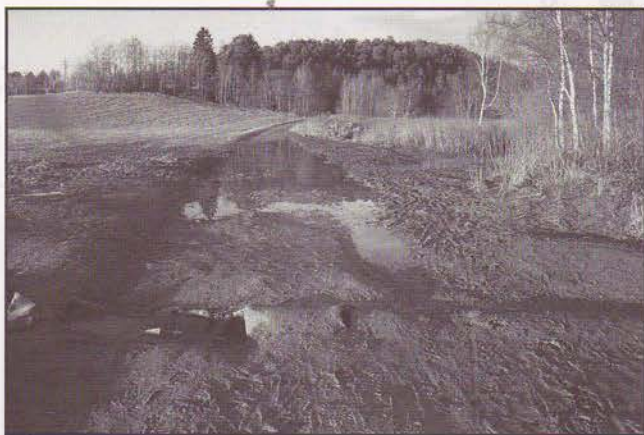
Sprukne sementrør og gjørme skapte problemer med turveien før utbedringen.
