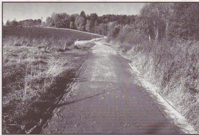
Turveien etter at utbedringene er gjennomført kan neppe sammenlignes med tidligere situasjon.
