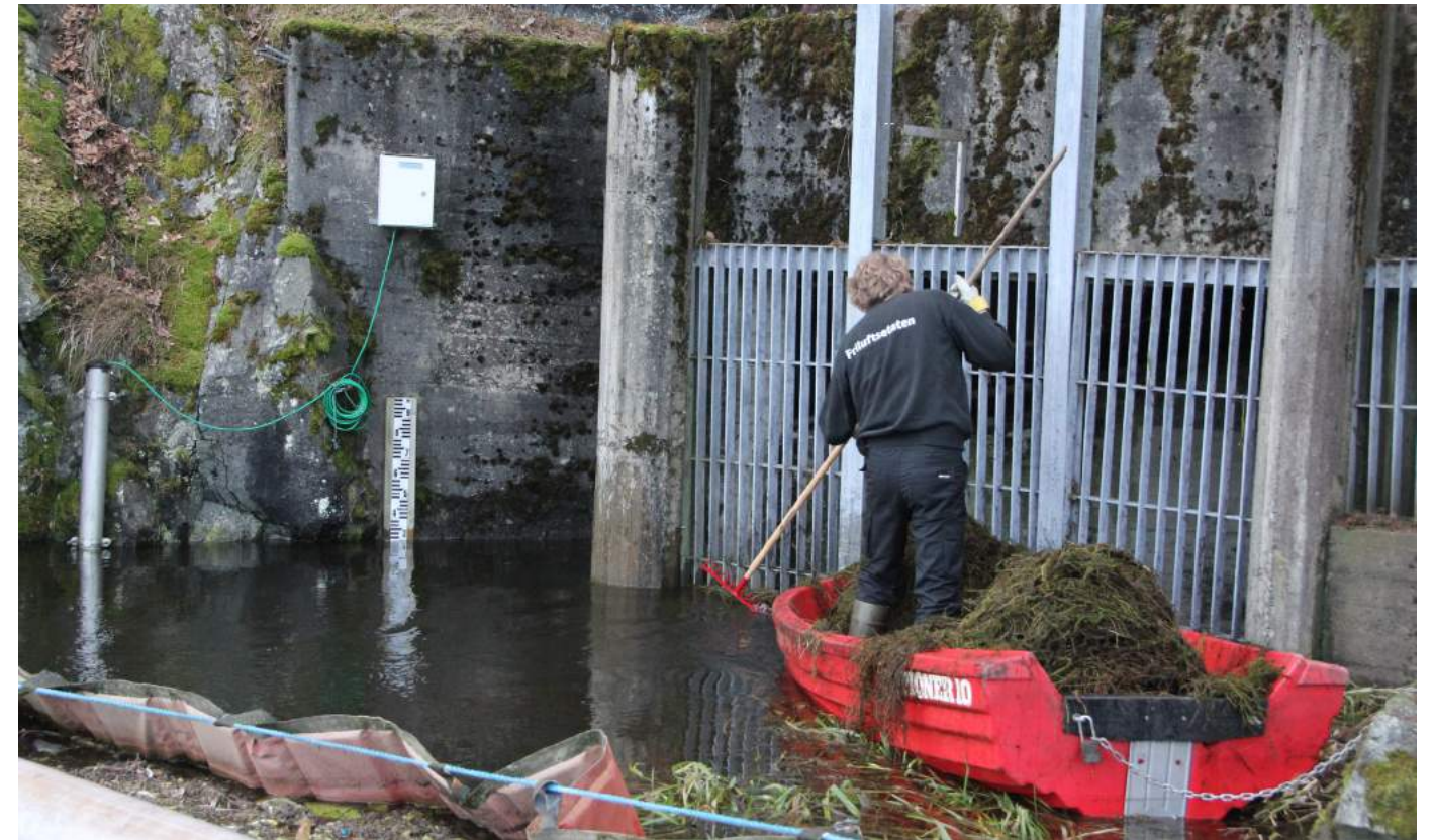
Rune Askvik i Bymiljøetaten fjerner vasspest fra gitteret ved utløpet i nordenden av Østensjøvannet. Vasspesten reduserer farten i avløpet og flom oppstår. Da dette bilde ble tatt 6. desember 2011 viste målestaven til venstre ca. 30 cm, dvs. minst 20 cm over «normal» vannstand.
