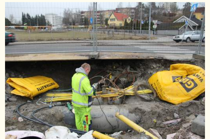
Mange kabler løper parallelt med fjernvarmerørene. Sensorer overvåker vanntransporten. Foto: Leif-Dan Birkemoe.
