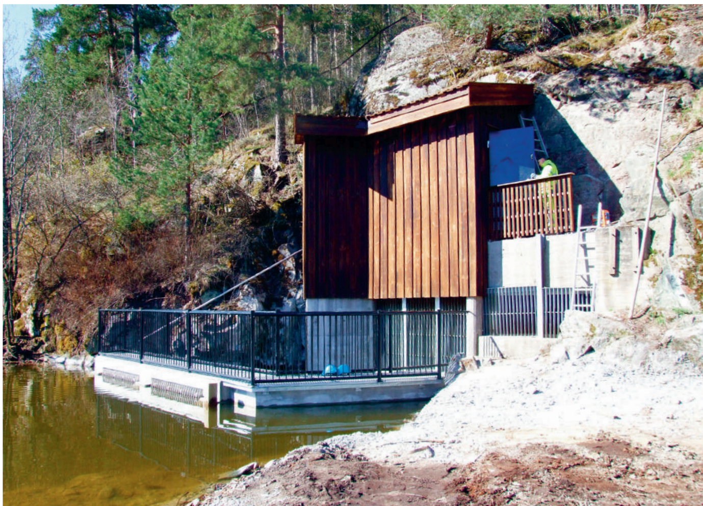
Reguleringsmekanismen er montert i damhuset. I tillegg er det satt opp en ytre ristkonstruksjon for å fange opp drivved, søppel og planterester slik at ikke dette tetter for damluken eller overløpet. Damluken, og derved vannstanden, fjernstyres fra Vann- og avløpsetaten. Foto: Amund Kveim 21.04.2015.
